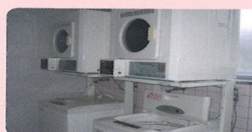
洗濯機・乾燥機
